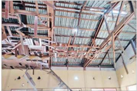
KIA နှင့် KPDF အကြမ်းဖက်သောင်းကျန်းသူများ ပစ်ခတ်လိုက်သည့် ရှေ့တိုက်ခွဲကျရောက်ပေါက်ကွဲမှုကြောင့် ဓမ္မပါလလယ်ပေါ်ဘုန်းတော်ကြီးကျောင်းဝင်းအတွင်းရှိ မြေနှင့်ဆီကျောင်းဆောင် ပျက်စီးမှုကို တွေ့မြင်ရစဉ်။
