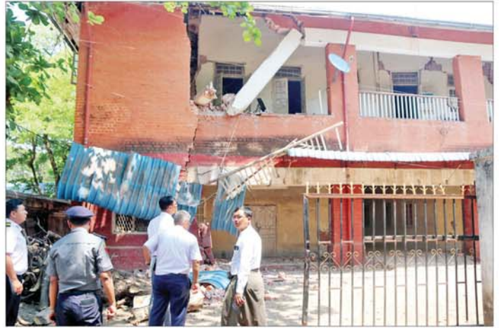
ငလျင်ဒဏ်ကြောင့် အဆောက်အအုံများပျက်စီးမှုကို တွေ့ရစဉ်။
